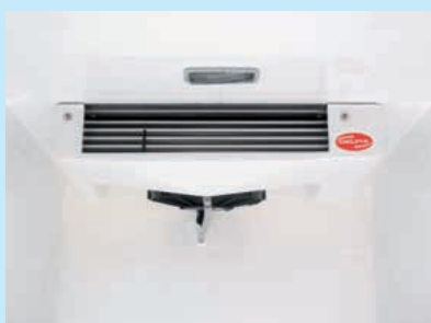
VÝPARNÍK DELPHI JE NAINŠTALOVANÝ V STROPE CHLADIACEJ KOMORY.
